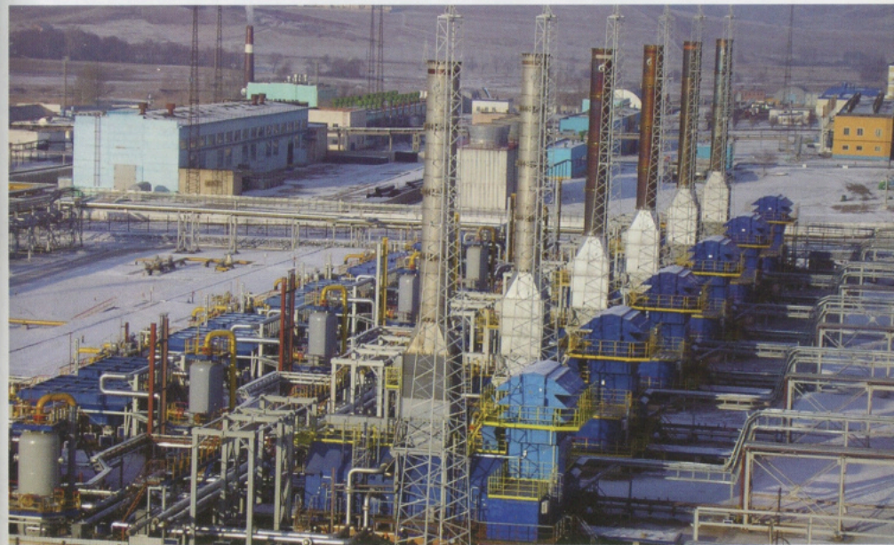
Канчуринско-Мусинский комплекс подземных хранилищ газа.
