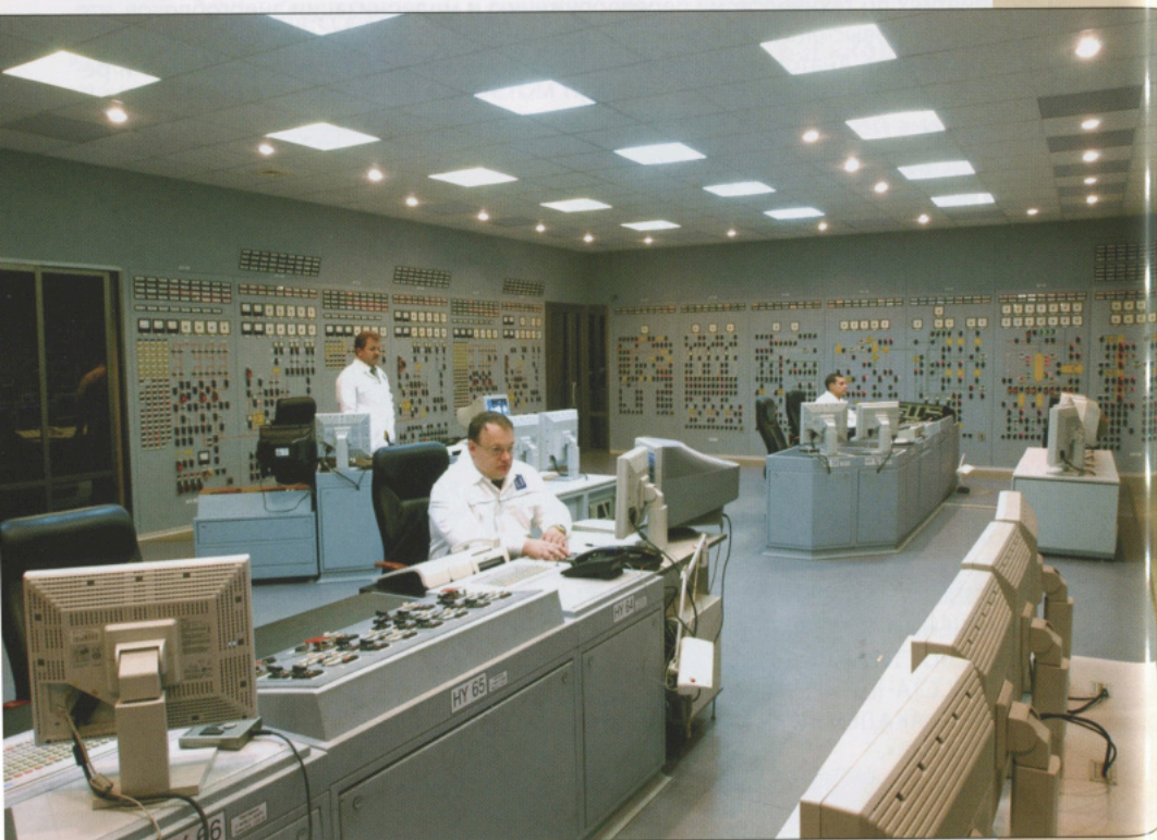
Блочный щит управления атомным энергоблоком Балаковской АЭС
