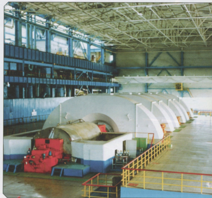
В турбинном цехе энергоблока
